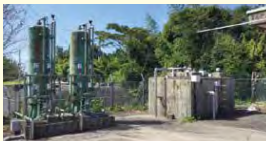
今回利用するゆーぶる吹上敷地内の既設ろ過施設
