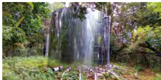
平成29年度完成のFRP製の100t貯湯槽と配湯管
