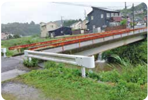
改修が急がれる猪鹿倉橋
