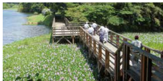
プラスチックと木質による材料を使用した 新しい橋の設置
