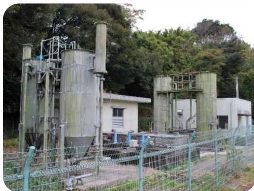
亀原水源地(深井戸 Q=100\text{m}^3/\text{日} )／亀原浄水場
