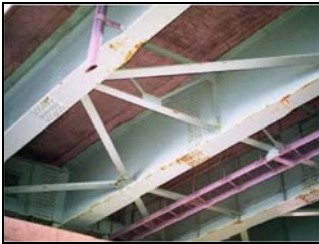
一部に表面的な錆
