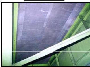
軽微なひび割れ
