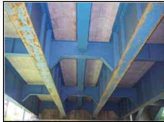
全体的に表面的錆
