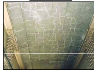
全体的にひび割れ
