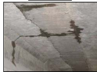
ひび割れから漏水
