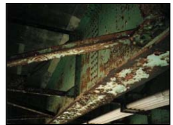
全体的に著しい錆
