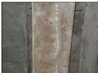
軽微な漏水・遊離石灰
