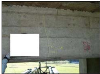
影響の大きいひび割れ
