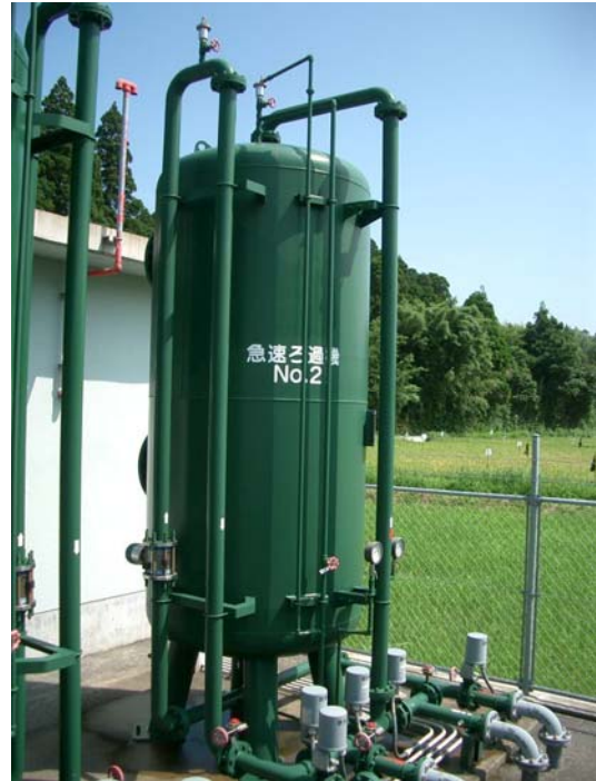
写真：吹上地域南部簡易水道急速ろ過器
