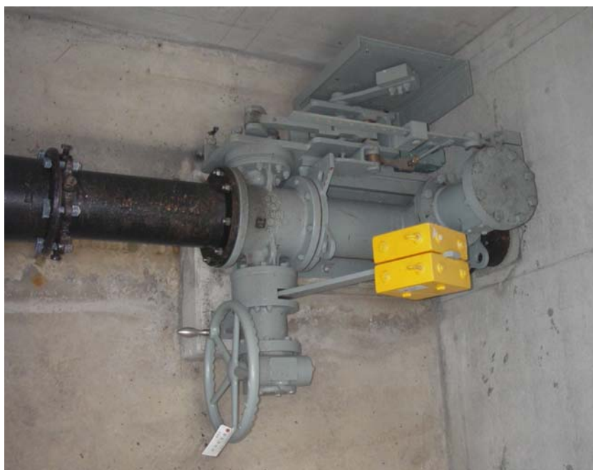
緊急遮断弁（妙円寺低区配水池）
