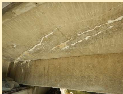
▲PC橋（ひびわれ、遊離石灰）
