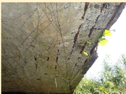
▲RC橋（鉄筋露出）
