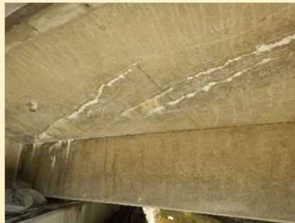
▲PC橋（ひびわれ,遊離石灰）
