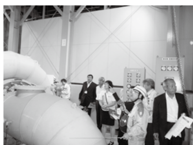
太田水力発電所の内部
