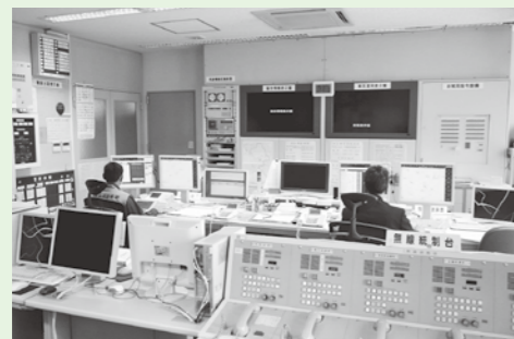
消防署指令室
