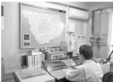
日吉支所の防災行政無線中継局
