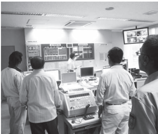
消防本部の通信指令台
