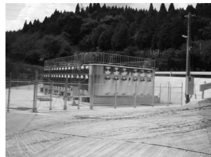
伊集院北地区の配水池
