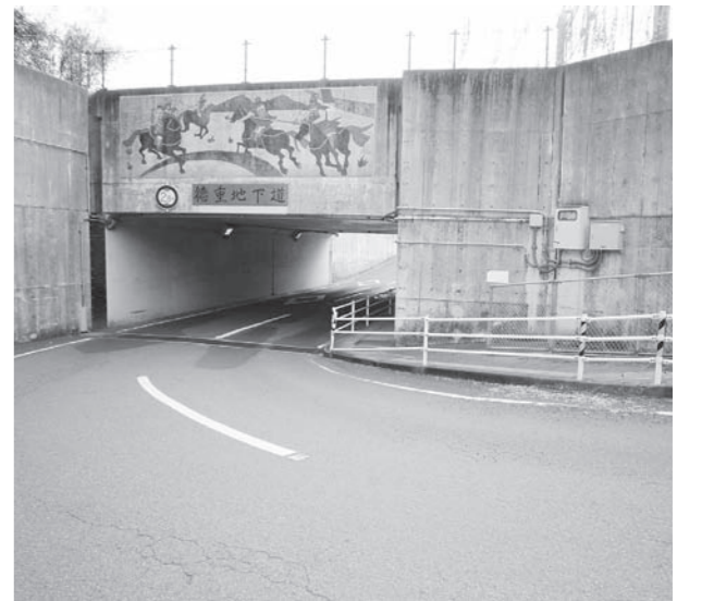
降雨時にポンプで排水を行っている地下道
