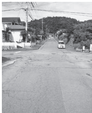
傷みが激しいつづじヶ丘団地内の市道
