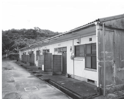
老朽化している市営住宅（伊集院地域）
