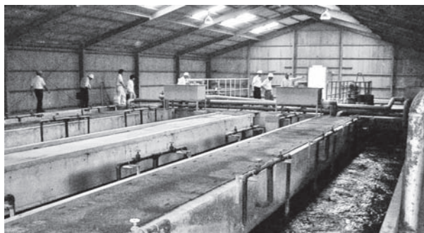
老朽化が激しいつつじヶ丘の下水処理施設
