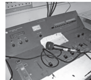
飯牟礼小学校の放送設備
