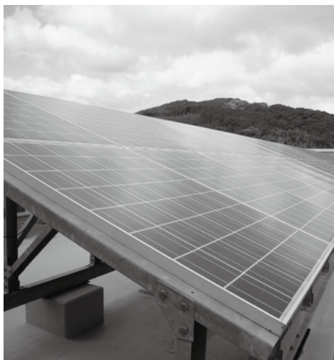
東市来中に設置している太陽光発電
