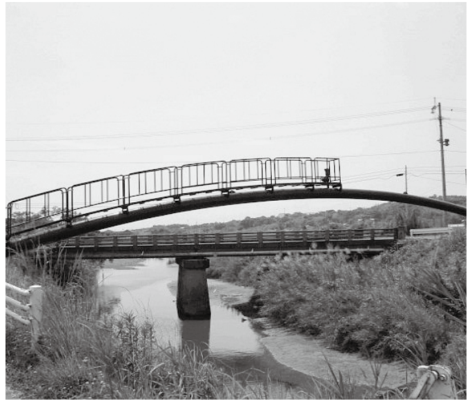
日吉地域県営かんがい排水事業の導水管
