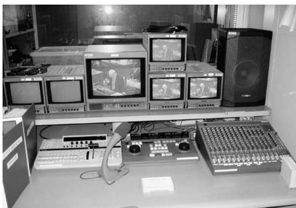
ケーブルテレビの設備（福岡県嘉麻市）
