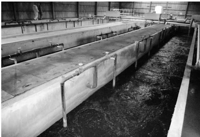
つつじヶ丘団地のコミュニティプラント内
