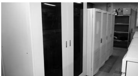
イントラネット整備事業で整備された機械（本庁）
