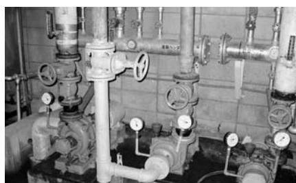
老朽化が進む配管（江口浜荘）
