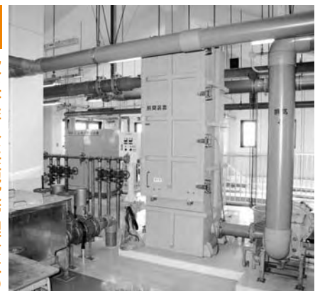
農業集落排水の処理場（永吉地区）
