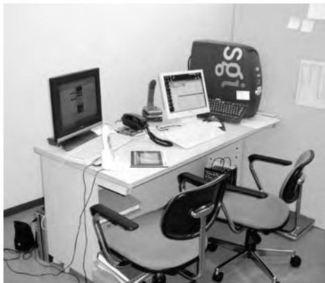
CATVの放送機器（熊本県南小国町）
