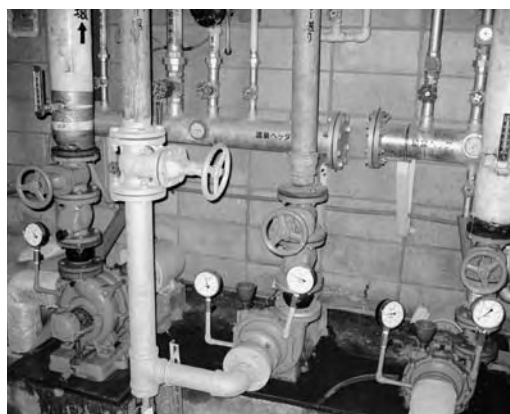
老朽化した江口浜荘のボイラー室
