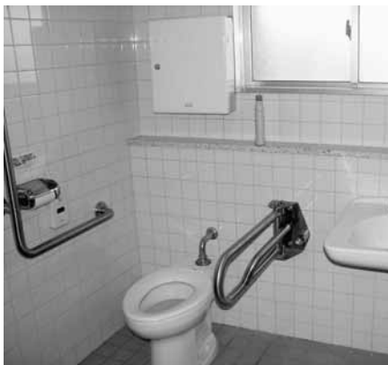
障害者用トイレ（妙円寺小）
