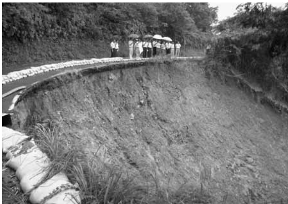
7月豪雨で被災した市道日添今木場線(吹上地域)
