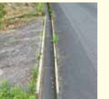
盗難被害に遭った現場
